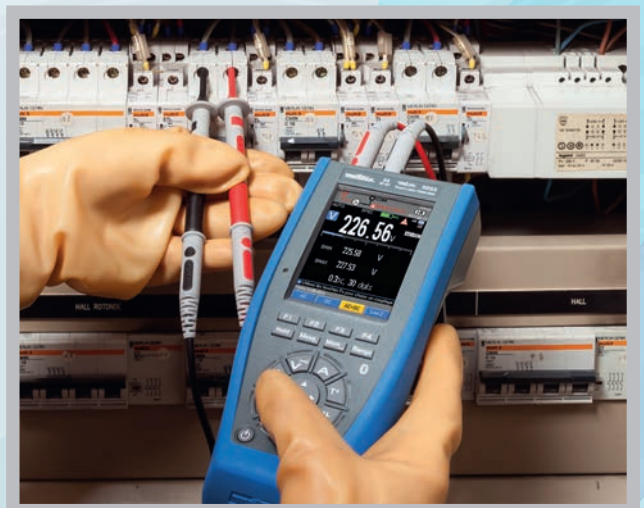
Mesures sur armoires électriques
